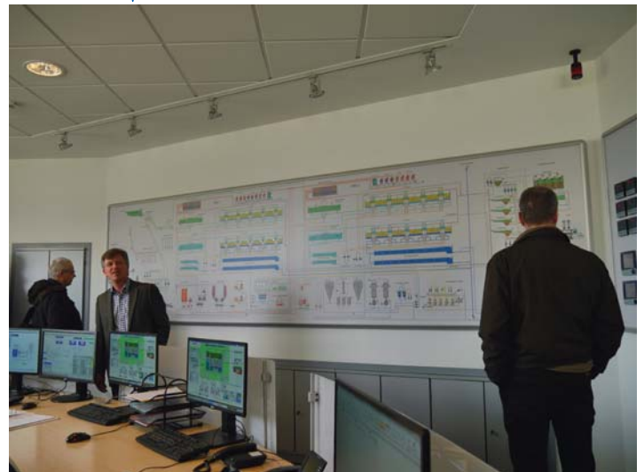
Bild 5: Übersicht Leitzentrale Wasserwerk Granetalsperre
