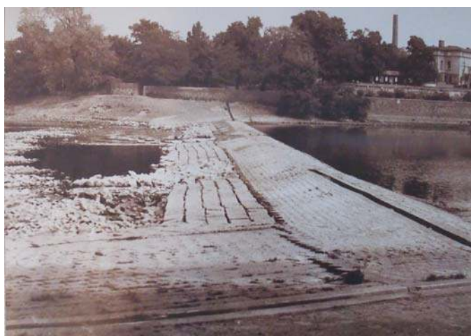
Abb.VIII-6: Die feste Wehrschwelle in der Magdeburger Alten Elbe, im Volksmund „Cracauer Wasserfall“, genannt- hier der Zustand 1964 vor der späteren Erhöhung um rd. 50 cm; rechts auf der Krone sieht man eine rechteckige (geflieste) Rinne zum Auffangen von Wollhandkrabben; (Foto: Helmut Faist)
