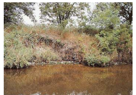
Abb. VIII-9 : Abgerutschte Böschung am Kanal (Quelle: WSA Magdeburg)
