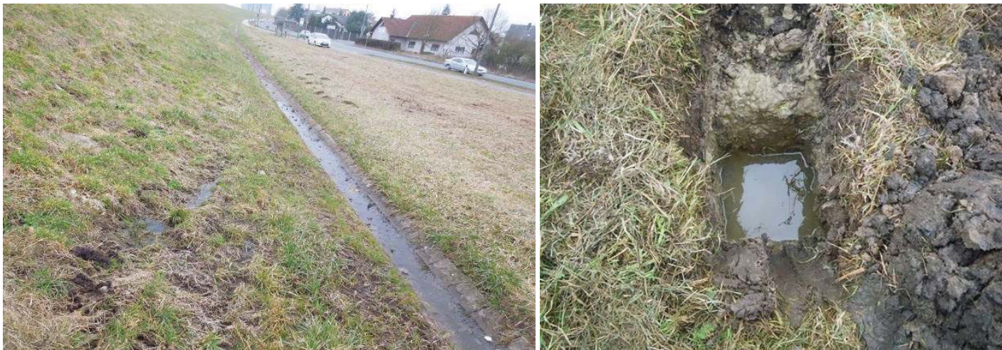
Abb. 3: Wasseraustritte am landseitigen Dammfuß und aufgegrabene Nassstelle
