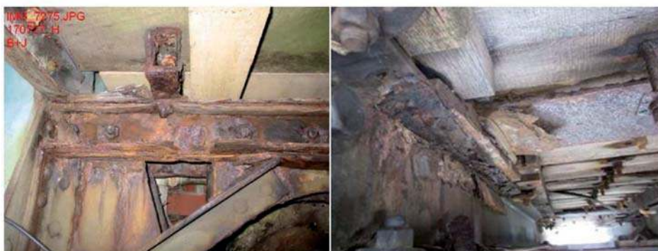
Abb. 8: Schäden am Tragwerk
