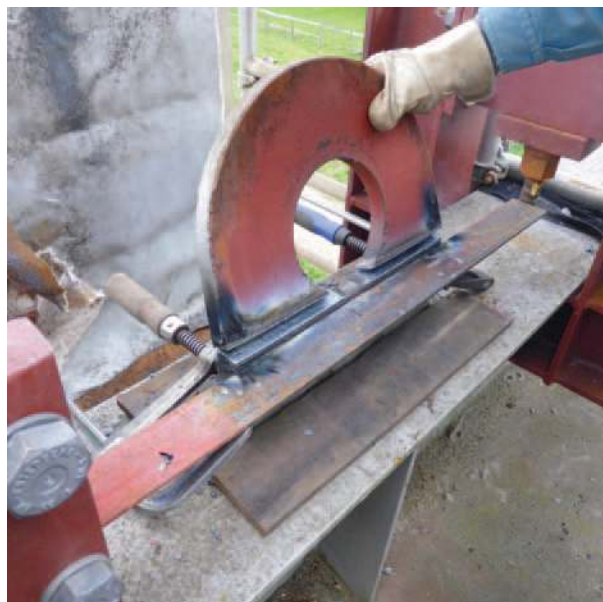
Bild 16: abgetrenntes unteres Blech
