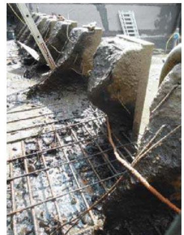
Abb. 7: Geschädigter Störkörper des Tosbeckens am Pulverweidenwehr
