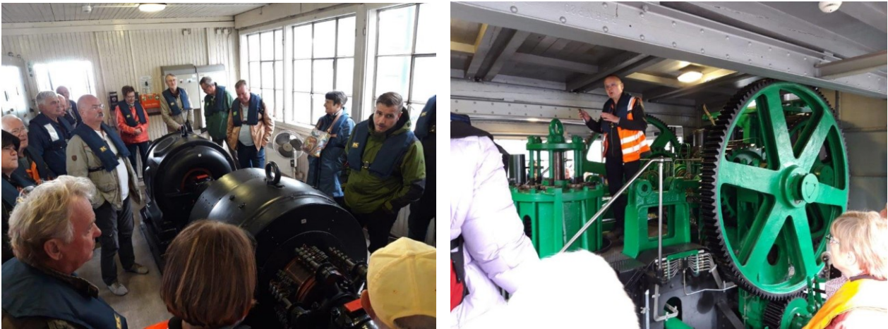
Faszinierende und gepflegte alte Technik: Maschinen- und Antriebsräume von 1934
