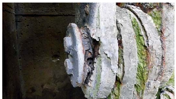
Bild 5: Schadensbild am Wehrverschluss
