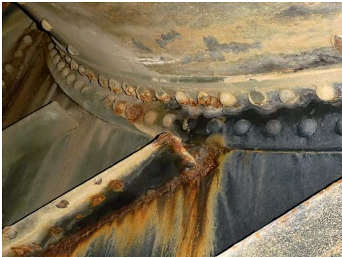
Bild 6: Schadensbild am Wehrverschluss
