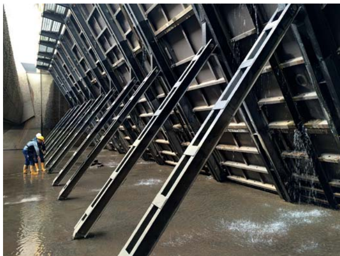
Bild 10: OW-Revisionsverschluss „System Schön“ im eingebauten Zustand am Wehr Rothenfels
