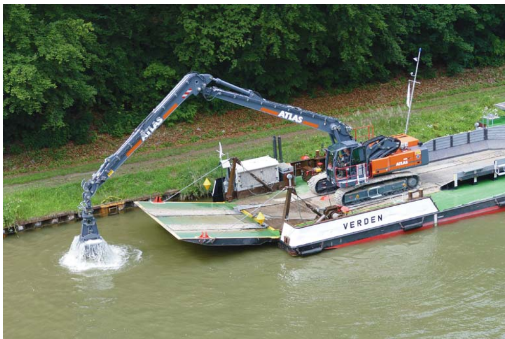
Foto 2+3: Der 43-t-Bagger ATLAS 340 LC blue bei Gewässer- bzw. Böschungsarbeiten vom Schiff aus.
