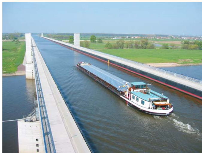
Abb. X-12: Ein Gütermotorschiff passiert die Kanalbrücke von Ost nach West (Fotos: WNA Magdeburg)
