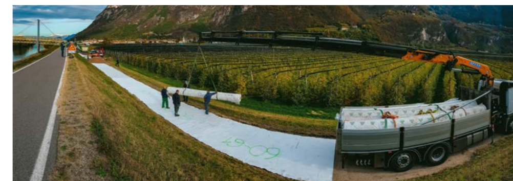
Einbau eines biologisch abbaubaren Trenn- und Filtervliesstoffs unterhalb eines Deichverteidigungsweges entlang der Etsch
