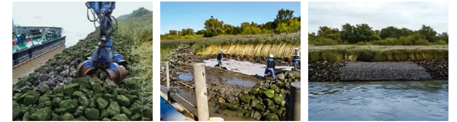
Absenkung des Deckwerks an der Elbe - Rhinplate [9]
