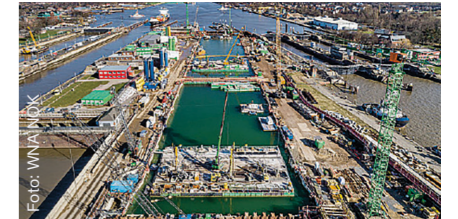
Blick auf die Großbaustelle für die fünfte Schleusenkammer am Nord-Ostsee-Kanal in Brunsbüttel
