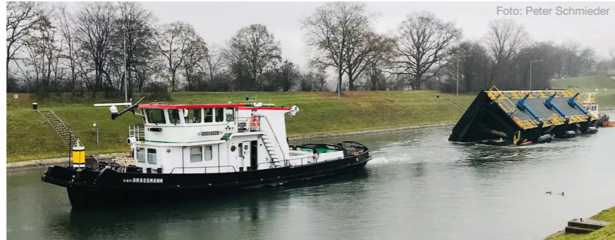
Nach Arbeiten am Wehr in Viereth bringen die Schiffe 'Von Grassmann' und 'Habicht' den Revisionsverschluss zurück nach Haßfurt.
