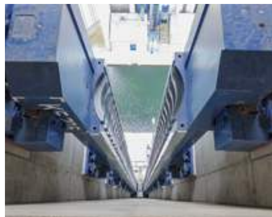
Bild 2: Blick von oben in eine der vier Mutterbackensäulen, in denen der Drehriegel bei der Fahrt ohne Berührung mitläuft und sich nur bei Ungleichgewicht als Havariefall nach oben oder unten anlegt und damit die Bewegung des Troges sofort stoppt
