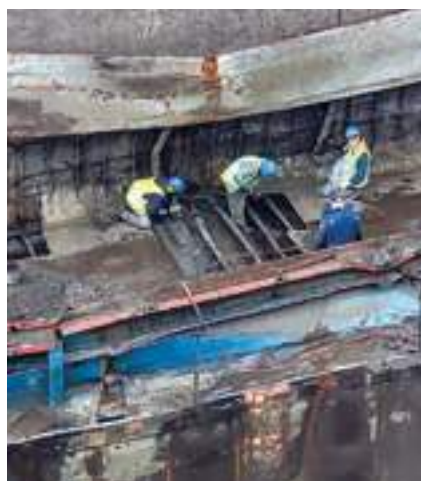
10. „Knick- bzw. Bruchstelle“
