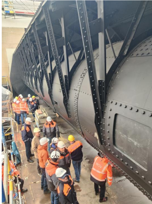
Bild5: Die Walze hat einen Durchmesser von 3,80 m und wiegt 112 Tonnen. Zur Erhöhung der Sicherheit bei der Unterhaltung wurden die Einstiegsluken vergrößert.
