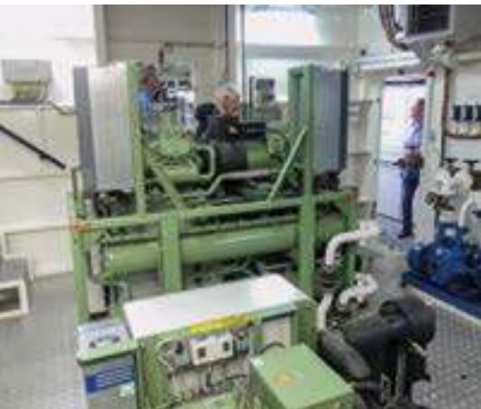
Blick in den Maschinenraum
