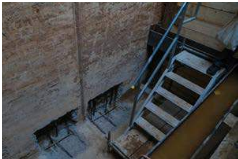
Freigelegte Bewehrung in Block 3+4
