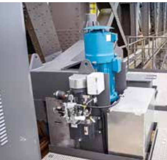
Abb. 11: Antriebseinheit am Balancier mit Hydraulik und Bremse (verdeckt unter Alukasten, Quelle WSA)
